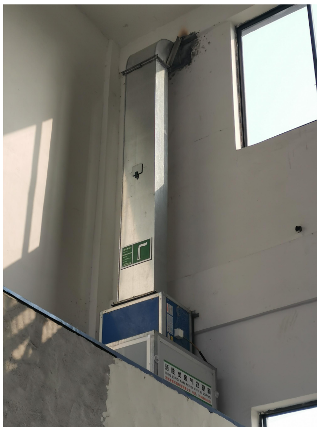
附图4.1-2 废气治理设施图
