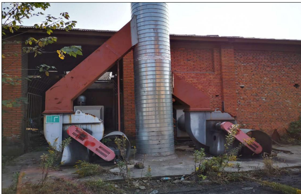
DA003 喷漆、晾干、拼板废气排气筒 过滤棉+二级活性炭装置
