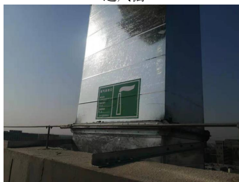
固体制剂废气排放口及标识标牌
