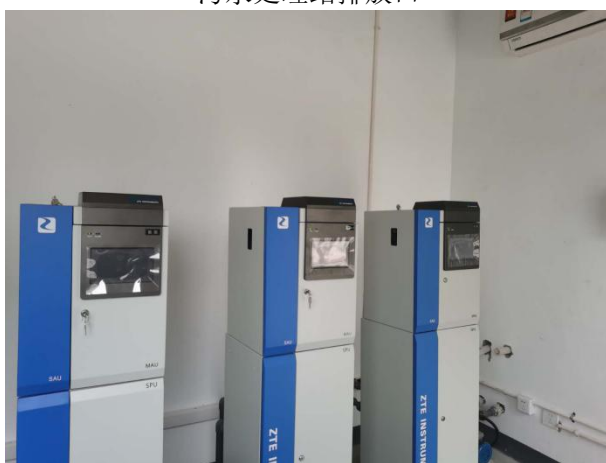
污水处理站在线监测仪器
